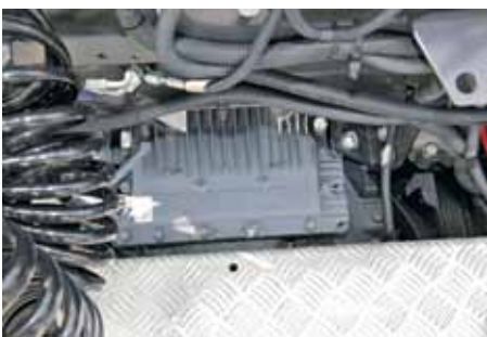
Блок управления коробкой передач ZF надежен и хорошо защищен от воздействия окружающей среды. К нему у ремонтников нет претензий
